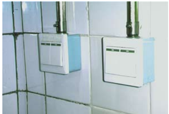
接线方式错误，应调整为下进下出
