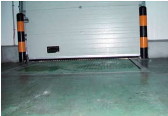
滑升门安装不气密，地面可见外侧光线，需重新安装调试
