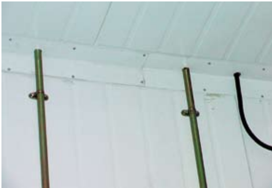
穿越冷库板的管路未做 PU 密封处理及打胶，需重做 PU 密封及打胶
